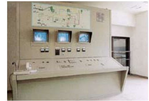
粗大ごみ操作室 本施設の運転は、集中的に監視制御されます。
