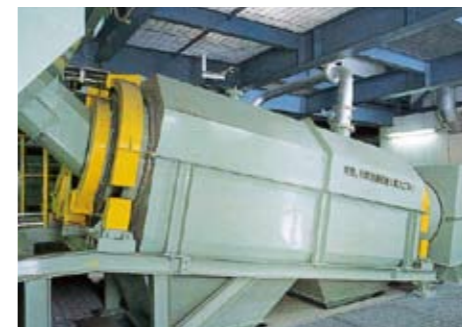
可燃物・不燃物選別機 鉄分を回収したごみは、可燃物と不燃物に分離されます。
