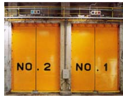
プラットフォーム 収集車が搬入したごみは、ここからごみピットへ投入されます。
