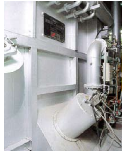
焼却炉 焼却炉でごみを完全燃焼します。
