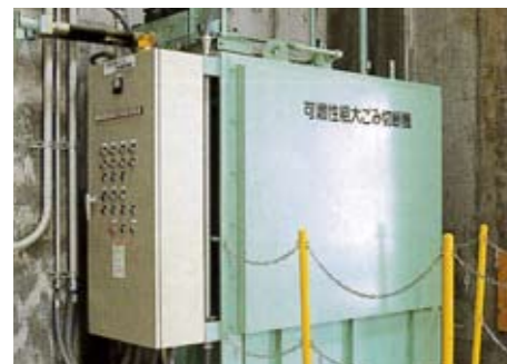
可燃性粗大ごみ切断機 可燃性粗大ごみは破砕されて、ごみビットへ投入されます。
