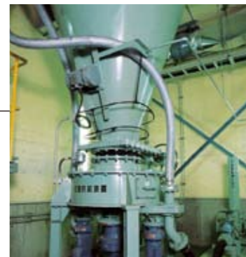
有害ガス除去装置 プラスチック等の燃焼によって発生する有害ガスは薬品と反応して無害化されます。
