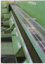
手選別コンベヤ 資源ごみよりガラス、その他を選別します。
